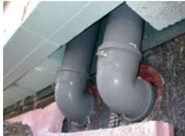
Abb. 9: Führung der Solarleitungen in der Außenwand
