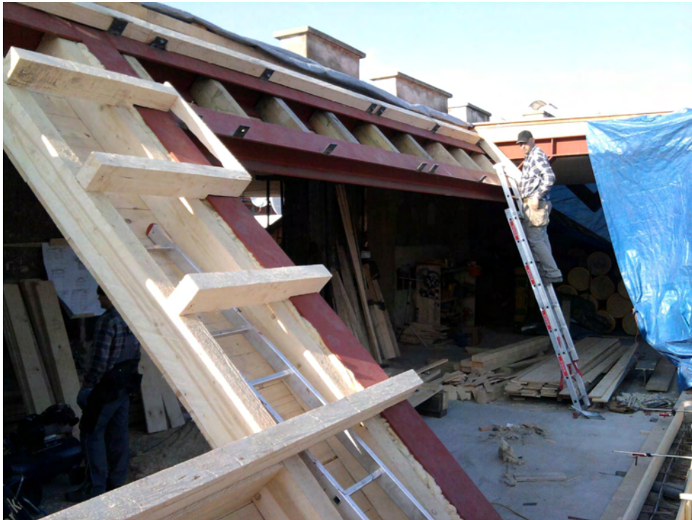
Abbildung 26: doppelschaliger Aufbau der Holzkonstruktion um die erforderliche Dämmstärke sicherzustellen [Schöberl & Pöll GmbH]
