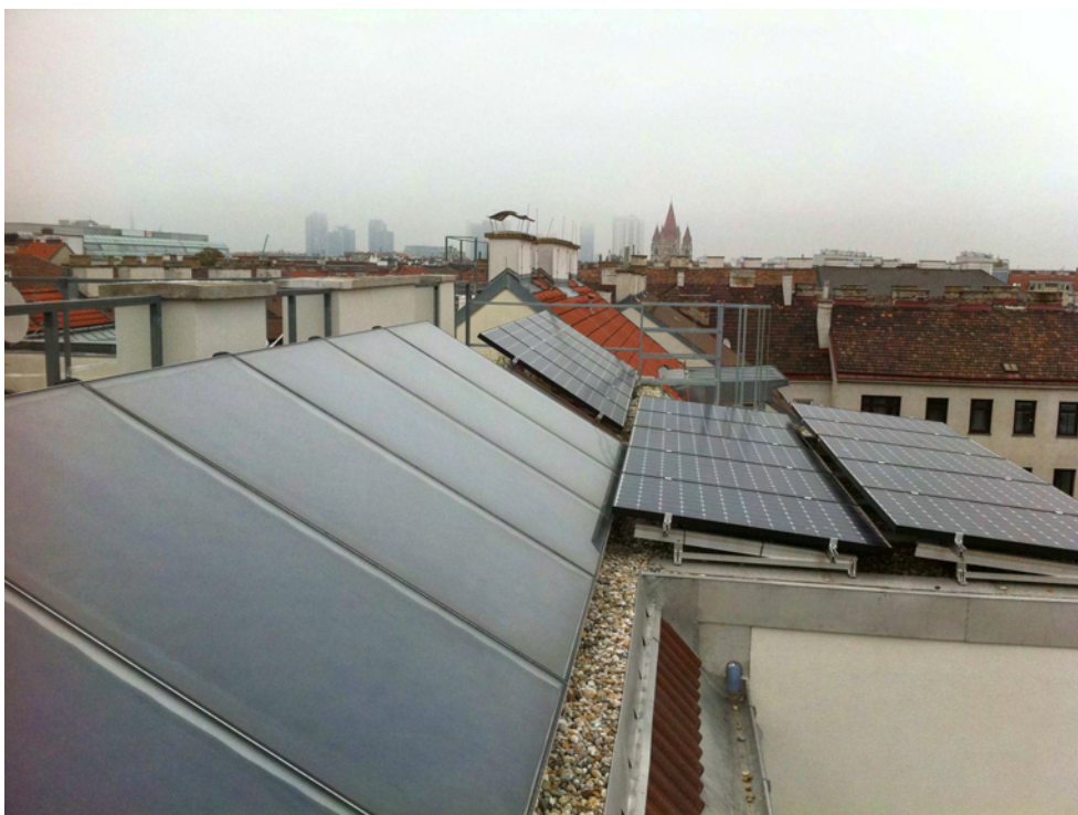
Abbildung 32: Solar- und Photovoltaikpanele auf der Dachfläche [Schöberl & Pöll GmbH]
