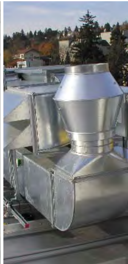
Zentraler Teil des Lüftungssystems über Dach
