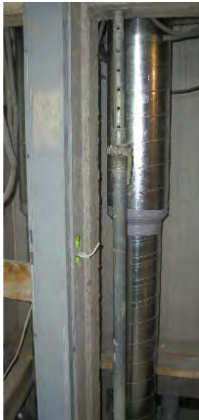
Schacht zur vertikalen Leitungsführung
