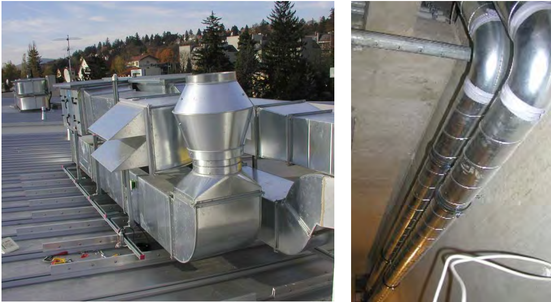
Abbildung 16: Aufdach- montierte Lüftungsanlage (zentrale Komponente) Fa. Huber&Ranner (links); Zentrale Lüftungsrohre im Versorgungsschacht im Stiegenhaus [AEE INTEC]
