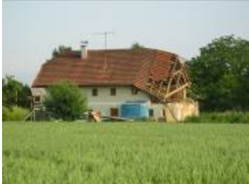
Durch Unachtsamkeit wurde die Dachkonstruktion ein Fall für die Schwerkraft
