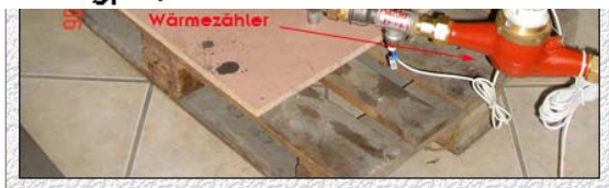
Bild 35: Prototyp 3, wasserseitig angeschlossen
