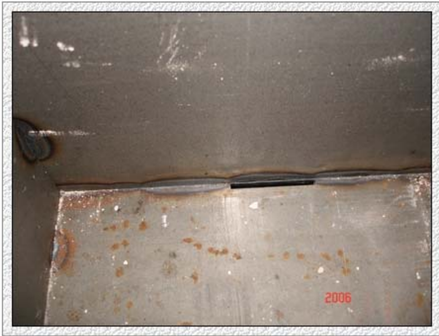
Bild 34: Prototyp 3. Zuluftschlitz im Boden
