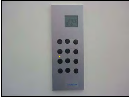
Abbildung 15: Regelungsschalter in der Energie Steiermark
