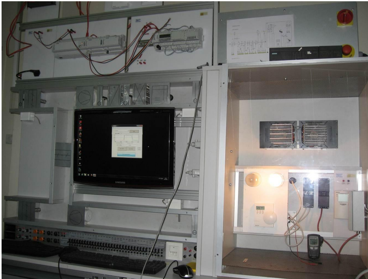
Abbildung 12: ThinkHome-Prototyp Installation in den Laborräumlichkeiten des Arbeitsbereichs, TU Wien.
