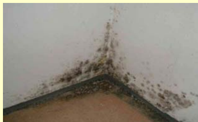
Schimmelbefall in unsanierter Raumecke durch deutliche Wärmebrücke
