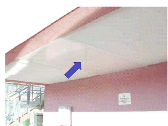
Durchgang Passivhaus mit Vakuumdämmung (blauer Pfeil)
