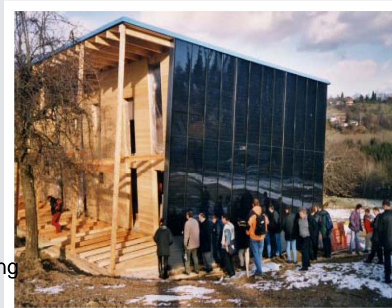
Abbildung 7.3: Testfassade mit 55 m 2 Kollektorfläche auf einem Zweifamilienwohnhaus in Graz
