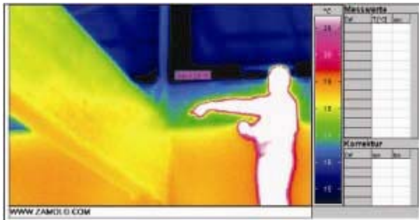
Bild 52: Atrium, Blick nach N, Leckage am Anschluß I-Träger zu vertikal eingebauten Fenstern der N-Wand
