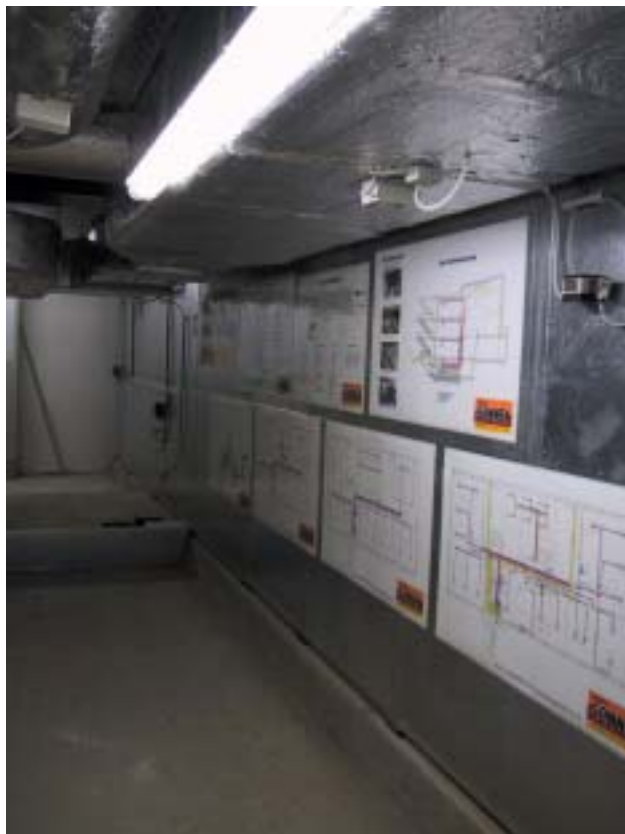
Bild 8: Lüftungsanlage u. Schaupläne W.E.I.Z
