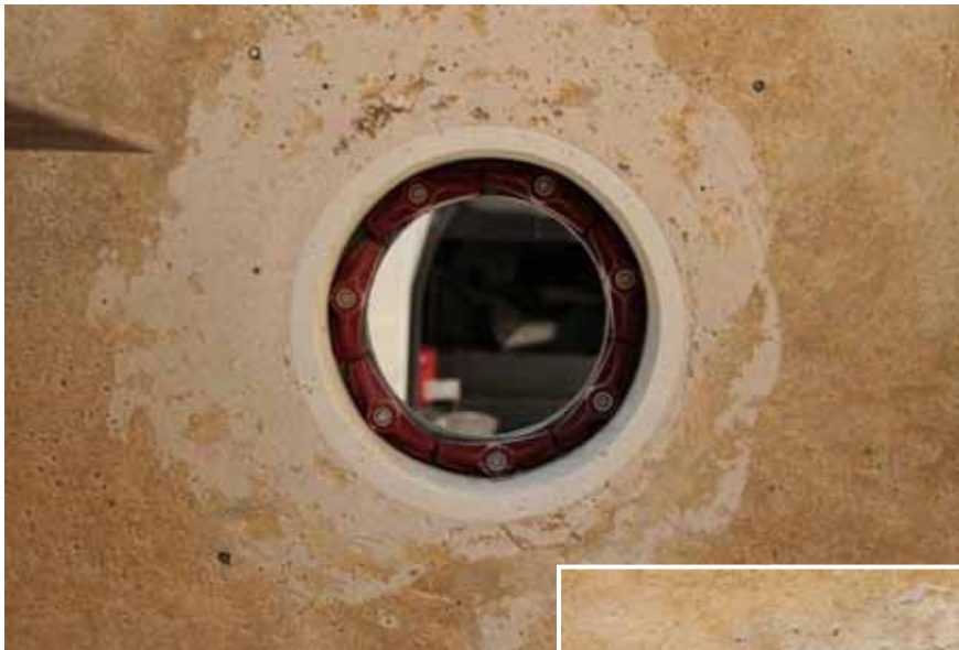
Rohrdurchführungen mit Ringraumdichtung
