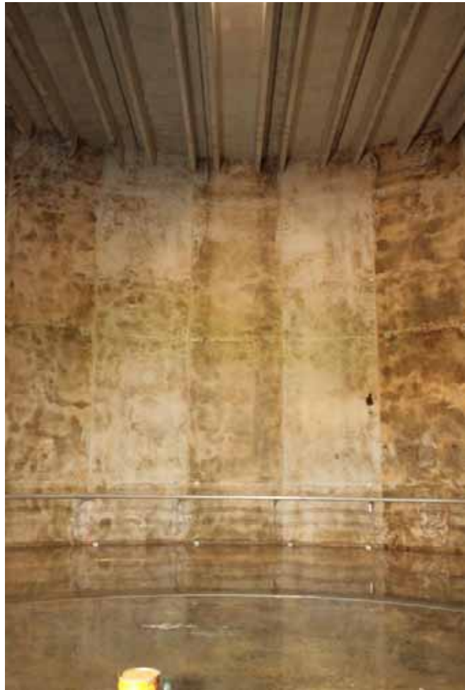
Geschlossener Behälter mit bereits eingebauter Heizleitung
