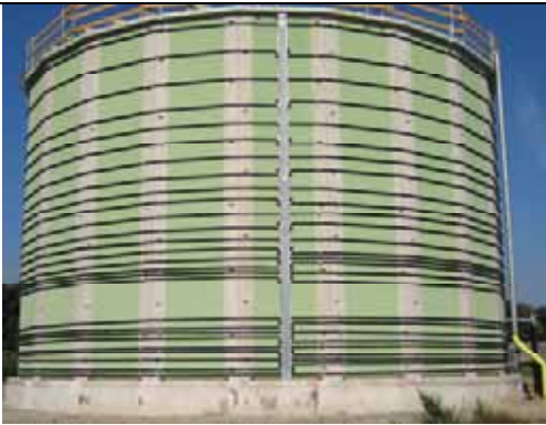
Bild 5: Nach dem Anbringen der Spannseile ist der MABA-Tank fertig für die Druckprüfung
