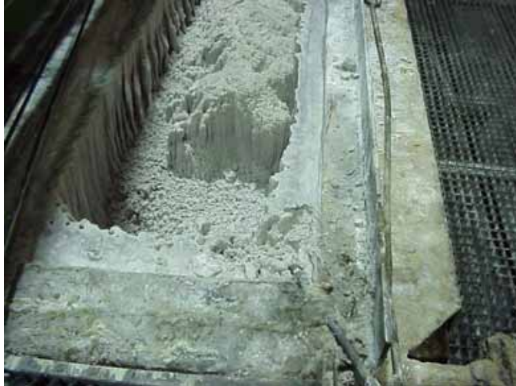
Abbildung 30: Patentieren 4; linkes Phosphatbad; Auslaufseite; vor Reinigung
