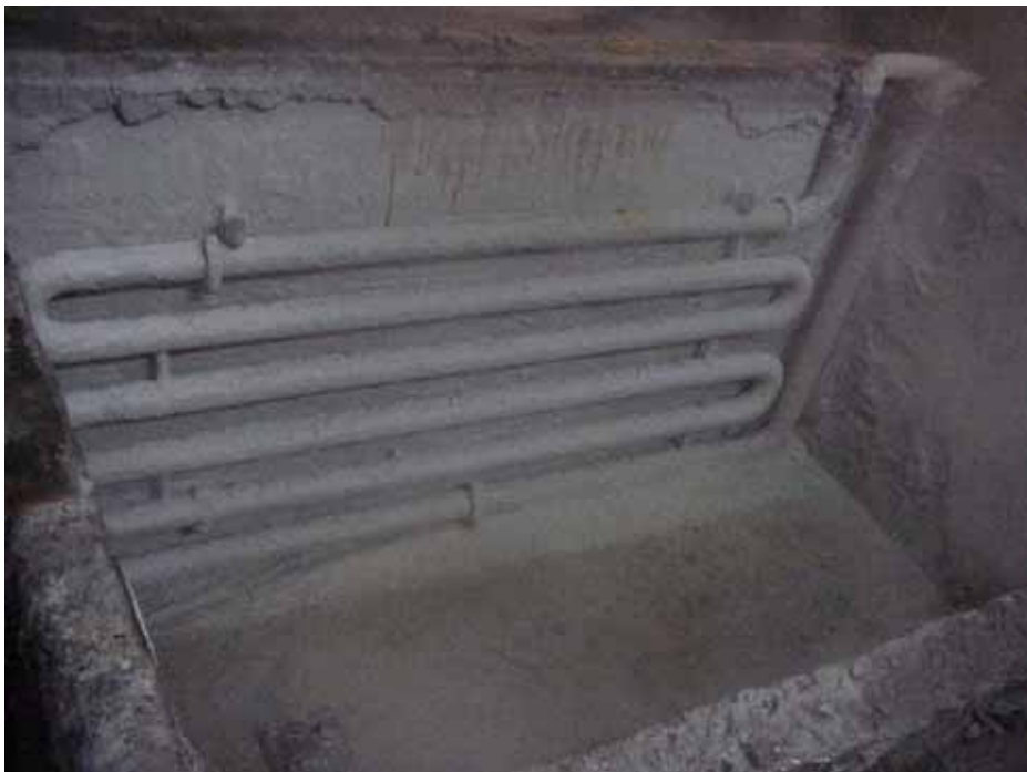
Abbildung 29 : Beizerei; Phosphatbad 2 aus dem die Flüssigkeit herausgepumpt ist. Am Boden der Phosphatschlamm; von linker Badseite gesehen
