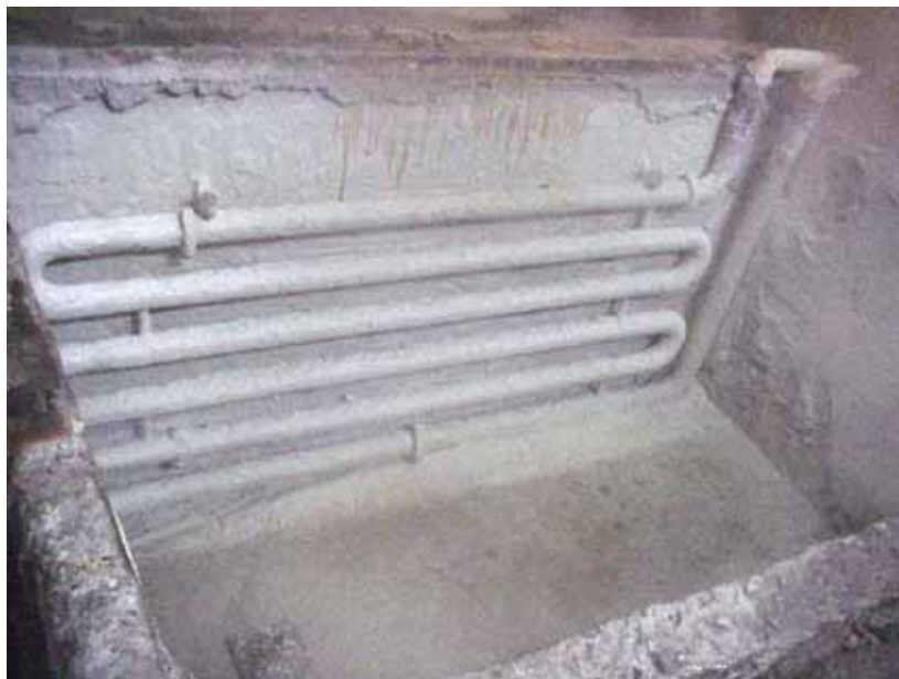
Abbildung 16 : Phosphatbad 2 (von der linken Badseite gesehen) aus dem die Flüssigkeit herausgepumpt ist; am Boden ist der Phosphatschlamm zu erkennen.
