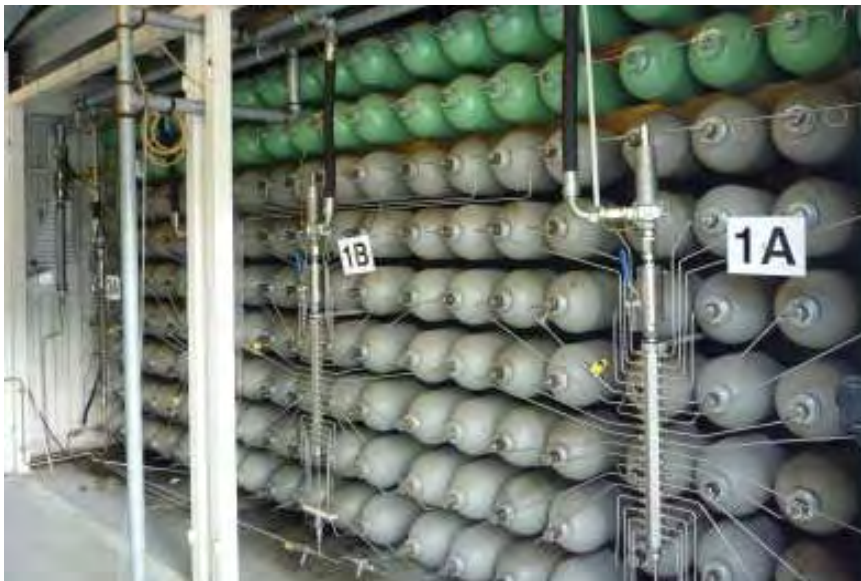
Abbildung 72: Typischer Biomethanspeicher bei kommunalem Projekt in Schweden (Quelle: New Energy)
