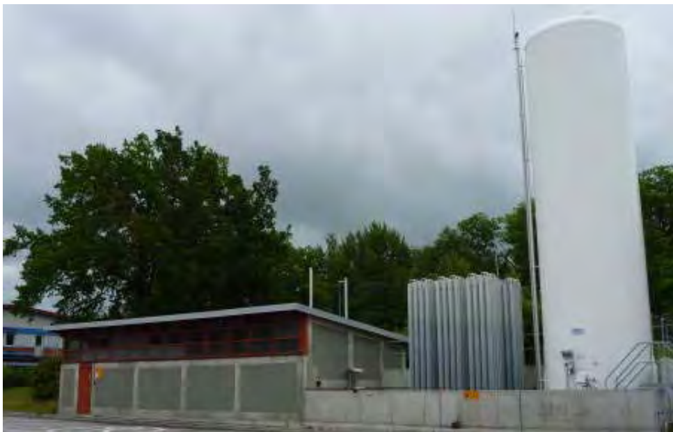
Abbildung 103: LNG Backup Anlage in Västerås (Quelle: New Energy)
