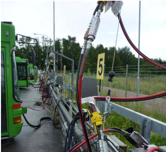
Abbildung 133: Slow-Fill Betankungsanlage für die Betankung der kommunalen Busse (Quelle: New Energy)
