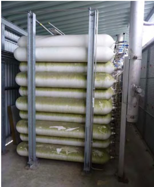
Abbildung 132: Gasspeicher Innenansicht (Quelle: New Energy)
