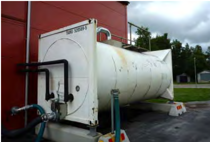
Abbildung 126: Speichertank für den biogenen Brei (Quelle: New Energy)
