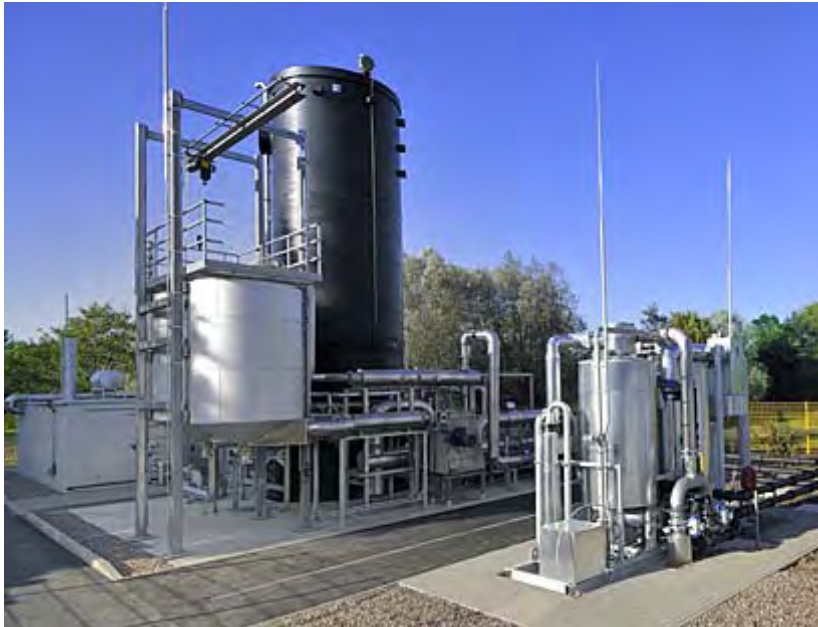
Abbildung 11: Aminowäsche der MT-Energie in Detmold (Quelle: MT-Energie)
