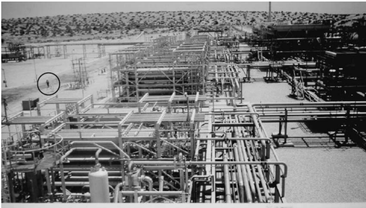
Abbildung 12: Membranverfahren zur Erdgasaufbereitung in Quadirpur/Pakistan (Quelle: MTR)
