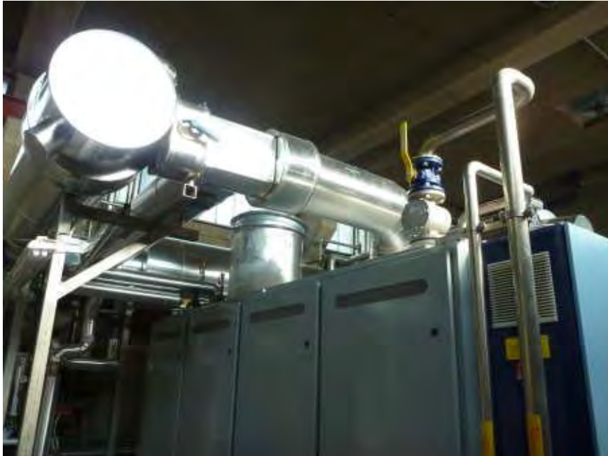
Abbildung 147: BHKW auf Kläranlage Knittelfeld (Quelle: New Energy)
