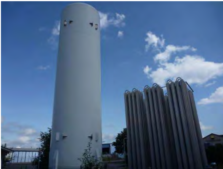
Abbildung 37: LNG-Backup in Uppsala / Schweden (Quelle: New Energy)
