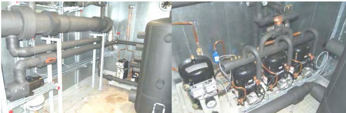
Abbildung 30: Gastrocknung vor Einspeisung in die Biogaspipeline in Steinfurt (Quelle: Bioenergie Steinfurt GmbH Co KG)
