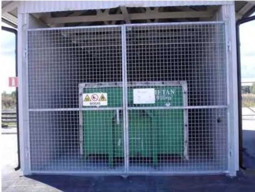
Abbildung 139: Biogastrailer Eskilstuna (Quelle: Eskilstuna Energi och Miljö AB)
