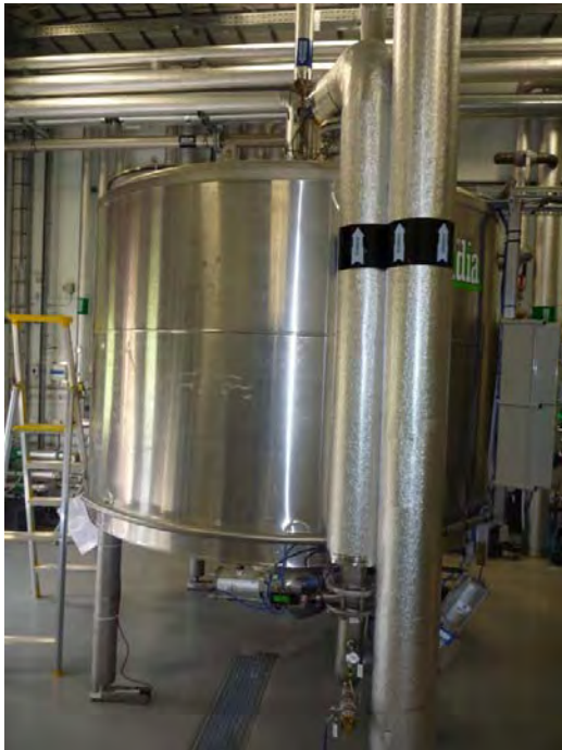
Abbildung 127: Hygienisierungsstufe (Quelle: New Energy)
