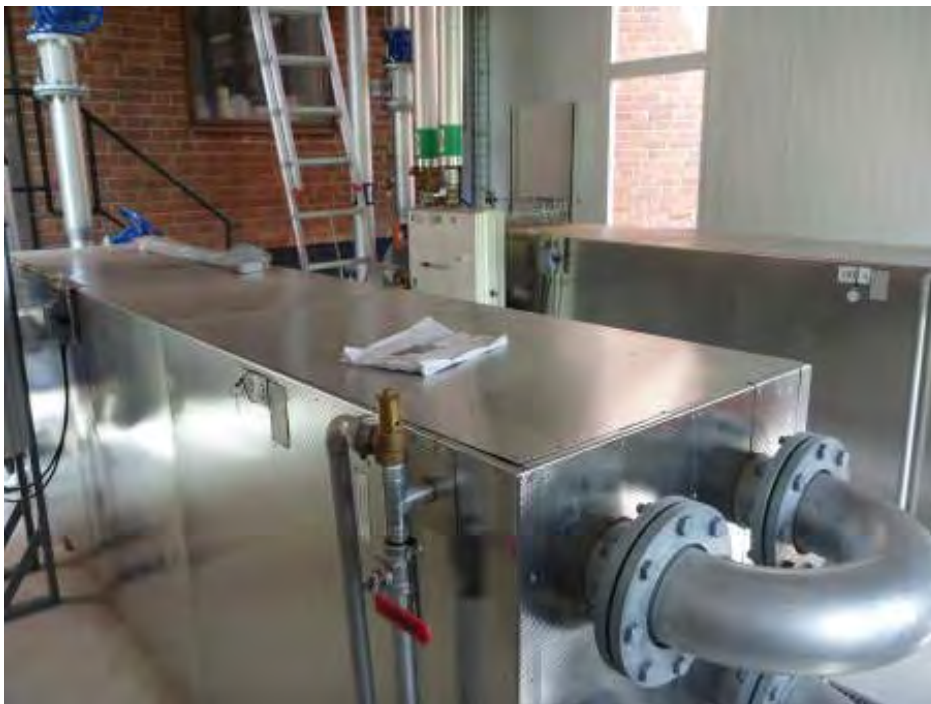
Abbildung 125: Wärmetauscher zur Beheizung der Fermenter in Eskilstuna (Quelle: New Energy)
