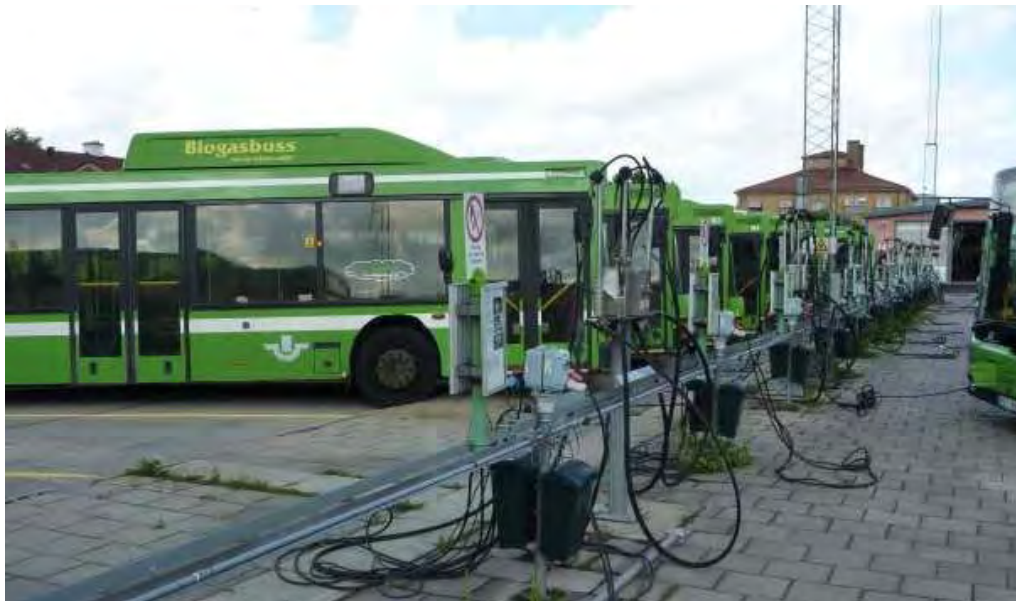
Abbildung 71: Slow Fill Betankungsanlage für Busse in Uppsala (Quelle: New Energy)
