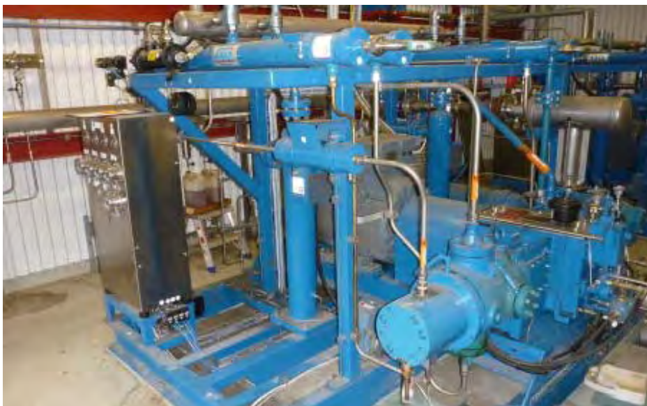
Abbildung 98: Kompressor am Standort Busdepot Västerås (Quelle: New Energy)
