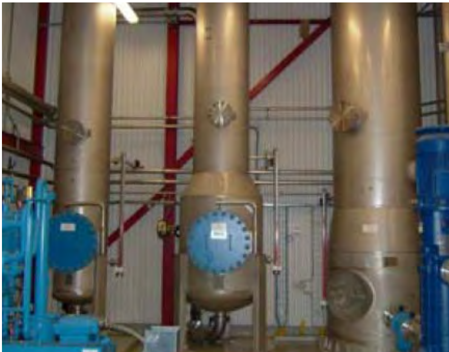
Abbildung 95: Innenansicht Aufbereitungsanlage auf Basis DWW in Västerås (Quelle: Svensk Vätkraft AB)
