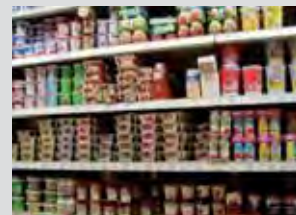
Energieeffiziente Lebensmittelkühlung in Supermärkten
