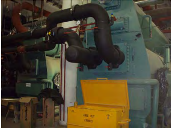
Abbildung 3: Fernkältezentrale TownTown: Absorptionskältemaschinen
