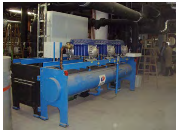
Abbildung 4: Fernkältezentrale TownTown: Kompressionskältemaschine
