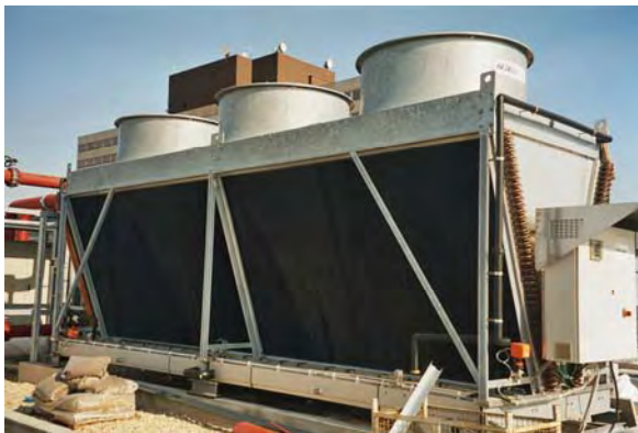
Abbildung 5: Fernkältezentrale TownTown: Hybridrückkühler
