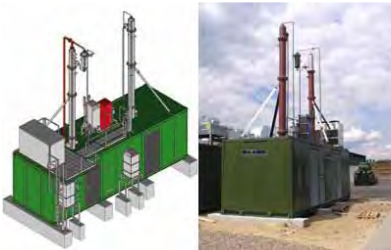
Abbildung 135: Biogasaufbereitung in Jameln (HAASE 2006)
