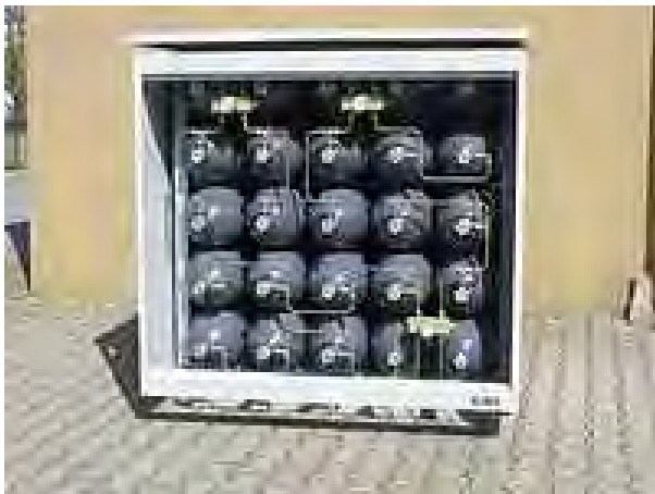
Abbildung 98: Hochdruckgasspeicher (BAUER KOMPRESSOREN 2008 )
