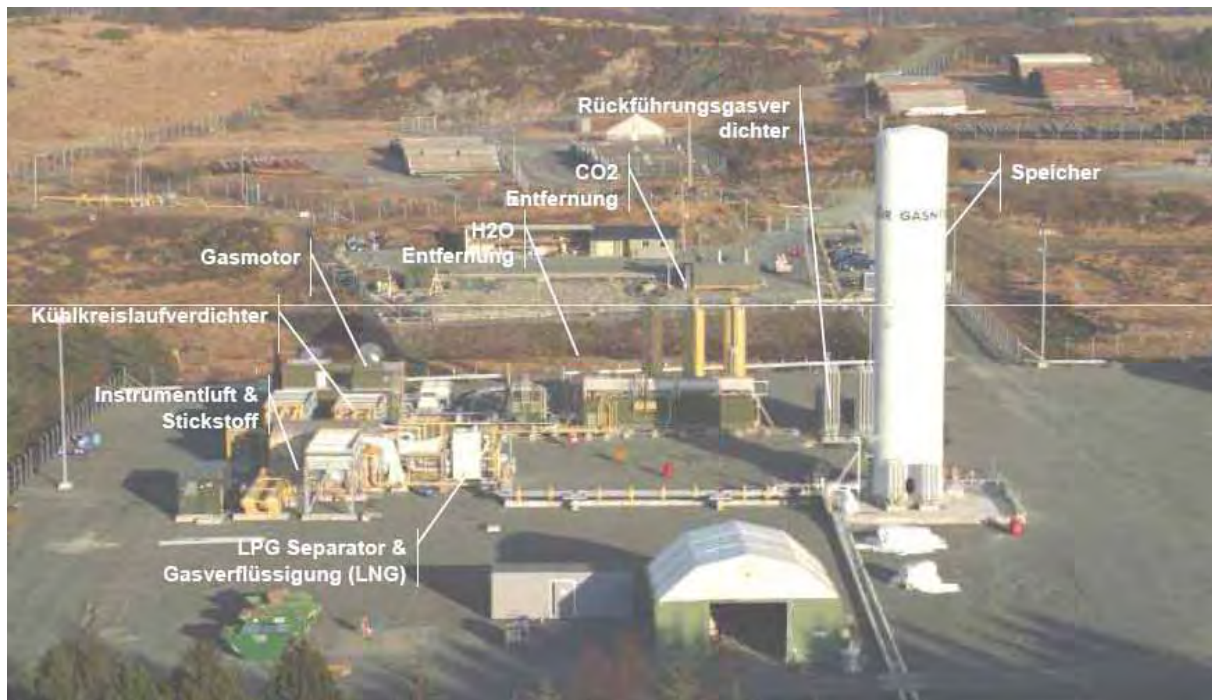
Abbildung 86: LNG-Anlage Snurrevarden (HAMWORTHY GAS SYSTEM 2008a)
