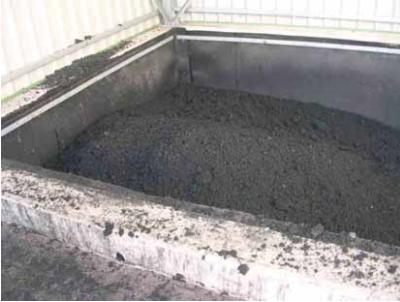
Abbildung 10: Aufgabebunker der Trocknungsanlage Frohnleiten
