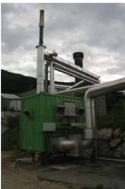
Abbildung 8 zeigt die Absaugung der Abgase der Klärgasmotoren und die Zuführung zum Abgas-Luft-Wärmetauscher des Trockners.
