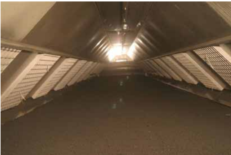
Abbildung 11: Trocknungstunnel des Bandrockners Frohnleiten
