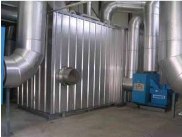
Abbildung 9: Bandrockner Frohnleiten mit Luftzuführung und Umluftgebläse
