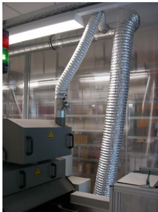
Abbildung 33: Abluftrohre des Reflow-Ofens
