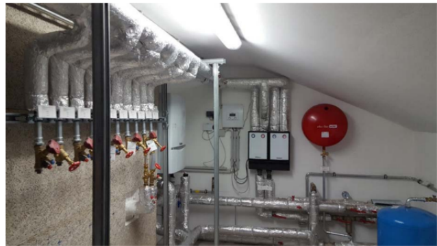
Abbildung 27: Haustechnikraum am Dachboden der Liegenschaft Miesbachgasse 10, Foto aus: „Zentralisierung“ von Gasetagenheizungen am Dach, Hsg.: Bundesministerium für Klimaschutz, Umwelt, Energie, Mobilität, Innovation und Technologie (BMK), Fotoquelle: Michael Cerveny, Energy Center Wien
