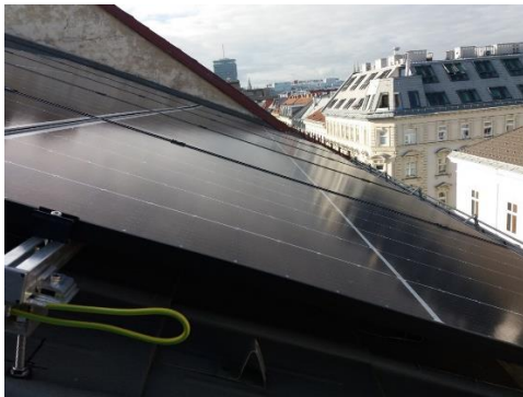
Abbildung 26: PV-Anlage am Dach der Liegenschaft Miesbachgasse 10
