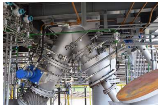
Erzchargierung Reaktor und Zyklonkreislauf, Foto: primetals.com
