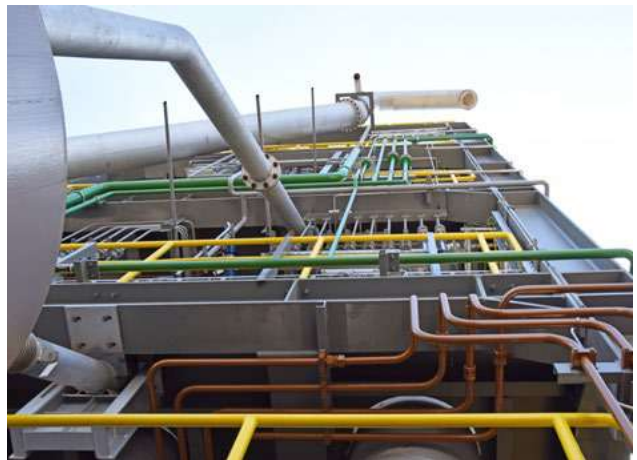
Ausschleuseleitung zum Produktkühler, Foto: primetals.com
