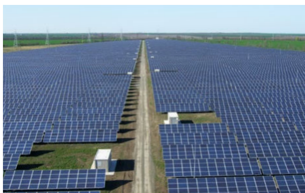
PV-Großanlage, Foto: AIT/T. Krametz
