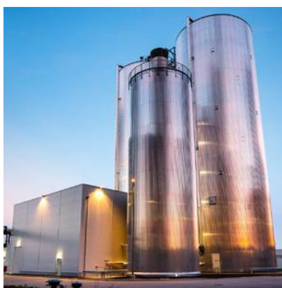
Hochdruck-Wärmespeicher Fernwärme Wien, Foto: Wien Energie/Ian Ehm
