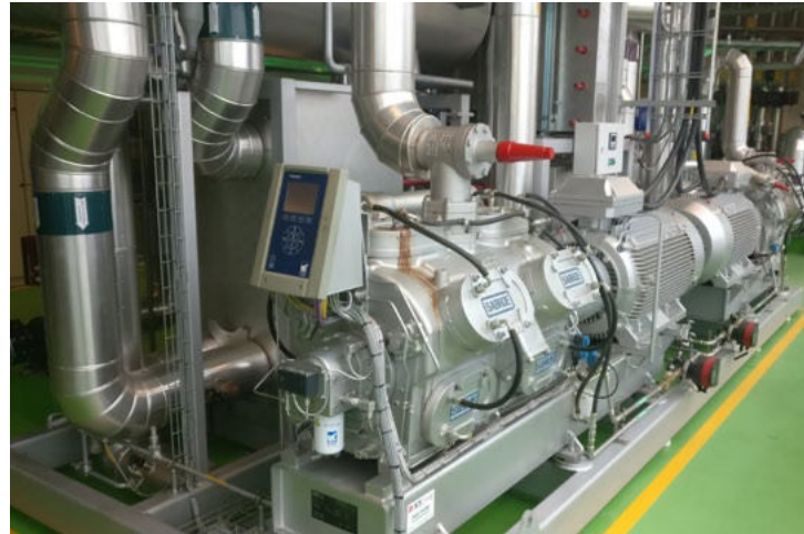
Wärmepumpe zur Einspeisung von Abwärme in Fernwärmenetze, Foto: 4ward Energy Research GmbH
