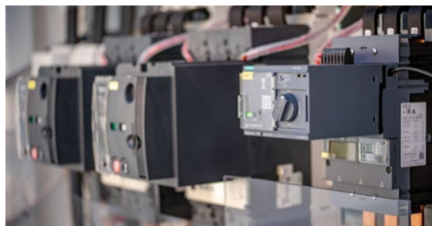
Steuerungen in einer intelligenten Ortsnetzstation, Foto: AIT / Oleksandr Melnyk
