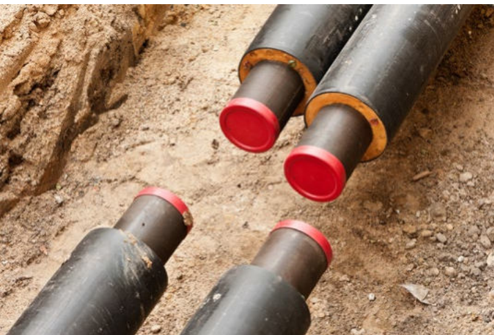
Fernwärmeleitungen, Foto: stock.adobe.com
