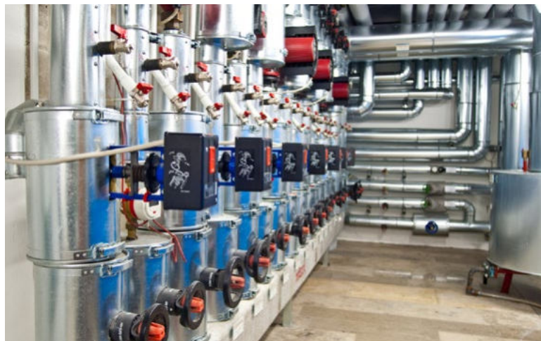
Fernwärme Hausverteiler, Foto: stock.adobe.com
