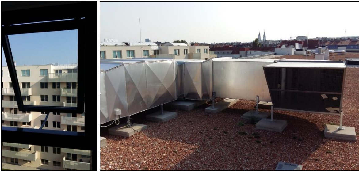
Abbildung 42: Komponenten der Nachtlüftung (v.l.n.r.): Zuluft-Fenster, Abluft-Anlage mit Fortluft-Gitter (Quelle: Peter Holzer)
