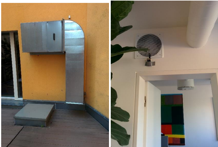
Abbildung 5-13: Komponenten der Nachtlüftung (v.l.n.r.): AUL-Ansaugung, ZUL-Gitter
