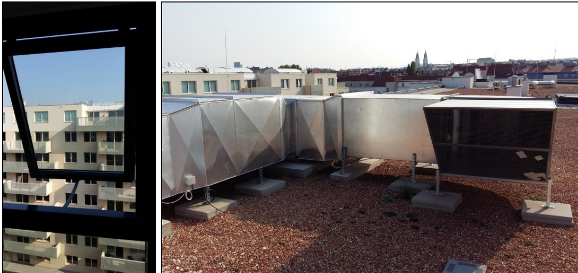
Abbildung 5-7: Komponenten der Nachtlüftung (v.l.n.r.): ZUL-Fenster, ABL-Anlage mit FOL-Gitter
