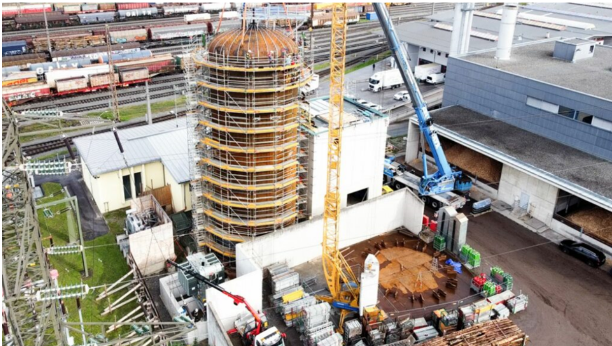
Abbildung 17 – Errichtung des Großwärmespeichers in Hall in Tirol mit 1.400 m 3 und 97 MWh thermische Kapazität mit Fertigstellung im Dezember 2022 Bildnachweis: © www.kremsmueller.com
