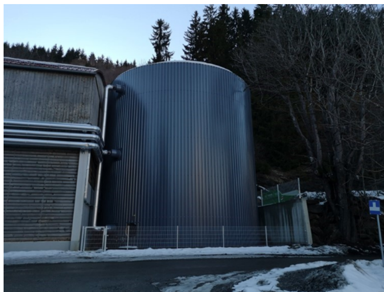
Abbildung 110 – Ansicht des 1.000 m 3 umfassenden Großwärmespeichers im Nahwärmenetz Friesach, Kärnten Quelle: AEE INTEC (2022)
