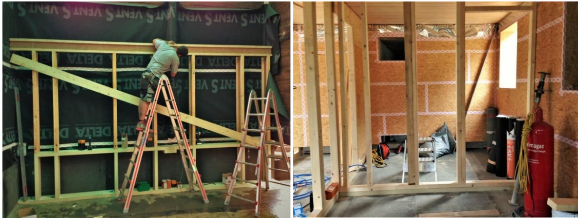
Abbildung 2: Links: Zu sehen ist das schwarze Windpapier sowie die Ständerkonstruktion für die OSB-Platten, © DI Hans Peter Gruber; Rechts: Ansicht der luftdichten Ebene (OSB-Platte), © DI Hans Peter Gruber
