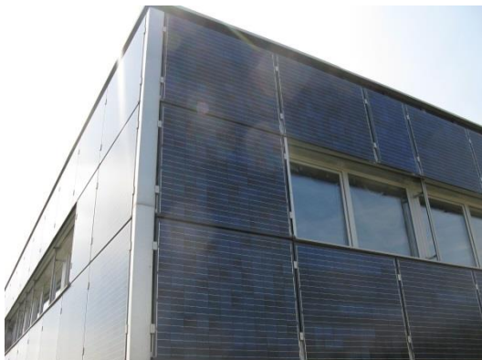
Z.B. Gebäudeintegrierte Anlage (BiPV): Kunden- und projektspezifisch gefertigte Fassadenelemente (Sol4-Gebäude, Mödling, © AIT).
