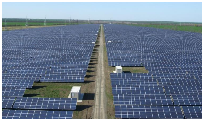
Z.B. Großkraftwerk mit 20 MWp 7 (© AIT) in Südosteuropa. Freifeld-Anlage, 40 Zentralwechselrichter, die paarweise über einen Blocktransformator ins Mittelspannungsnetz einspeisen.
