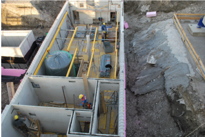
Abbildung 12: Kellergeschoß (mit Pufferspeicher), aufgenommen am 10. April 2015 Foto: Wolfgang Lackner
