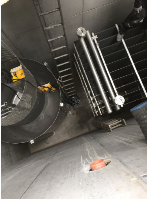
Abbildung 2: Abwasserschacht mit Filter und Wärmetauscher Foto: TB Stampfer
