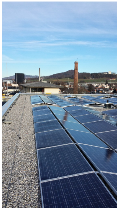
Abbildung 3: PV-Anlage auf der Dachfläche des neu errichteten Eco-Suite Hotels Foto: TB Herrmann
