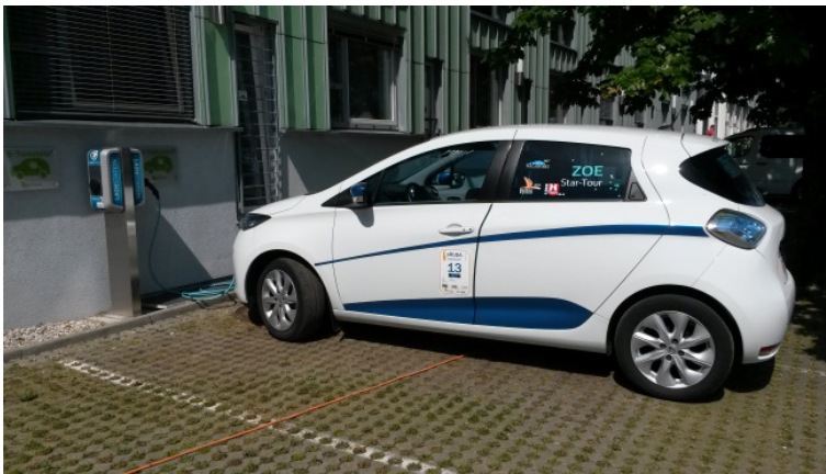
Abbildung 1: Ladesäule auf dem Parkplatz vor dem Kolpinghaus
