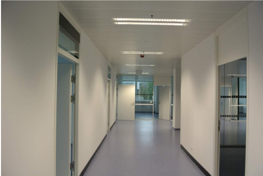
Abbildung 17: Beleuchtung im Gangbereich (Quelle: ATP)
