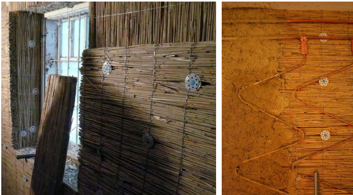
Abbildung 32: Schilfrohr-Innendämmung – links: Fensteranschluss mit innen gedämmten Fensterlaibungen (einlagig mit 5cm Schilfrohr); rechts - Wandheizungselemente aus Kupfer mit erster aufgebrachtter Lehmputzschicht
