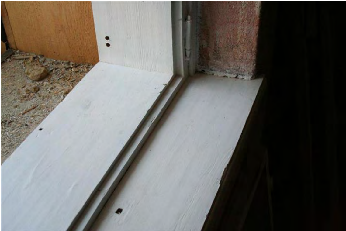
Abbildung 42: Holzoberfläche eines sanierten Kastenfensters, mehrschichtige Behandlung mit Leinölpräparaten zur Revitalisierung des Holzwerkstoffes
