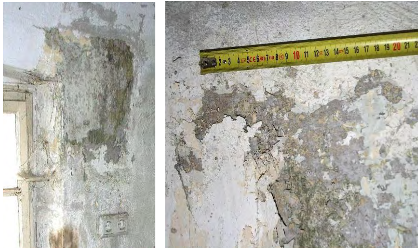
Abbildung 72: Schimmelbildung an der Oberfläche der Innenseite der Außenmauern im Erdgeschoß (nordseitig)
