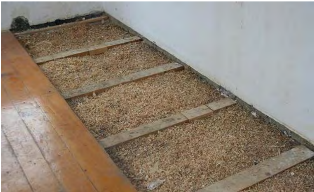
Abbildung 104: Freigelegter Fußbodenaufbau mit Sicht auf Sägespäne (Füllstoff) – Zone 4
