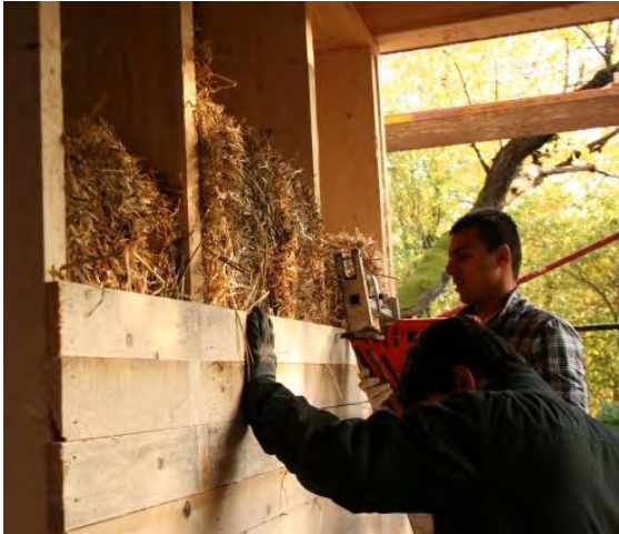
Abbildung 30 – Die bereits mit Strohballen gedämmten Bereiche werden im Anschluss mittels einer Rauschalung verschlossen – GrAT
