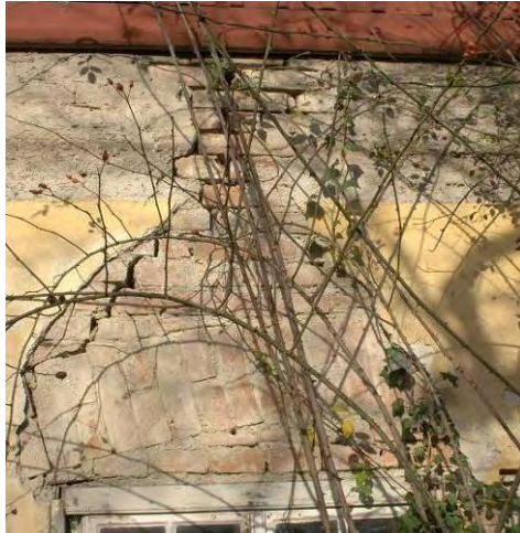
Abbildung 70: Vertikaler Riss in der südlichen Außenmauer aufgrund Seitenschubs der Dachkonstruktion
