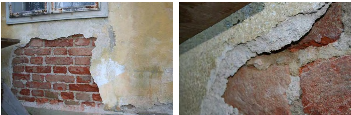
Abbildung 71: Großflächige Fehlstellen im Kalkputz der Außenfassade
