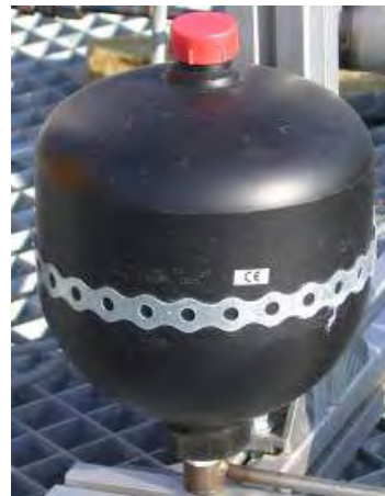
Abb. 61: Membrandruckspeicher im Kollektorkreis
