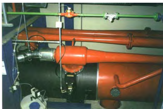
Abb. 1: 600 kW-Maschine der Energieversorgung Gera (Bildquelle: Fraunhofer UMSICHT)
