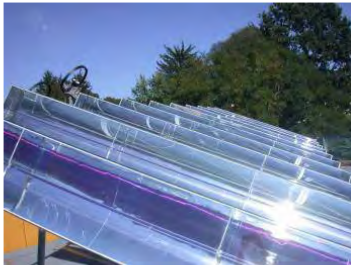
Abb. 99: 10 Parabolrinnenkollektoren am Teststand in Gleisdorf
