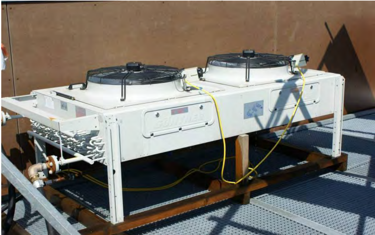
Abb. 130: Rückkühleinheit auf dem Dach des Laborgebäudes der AEE INTEC in Gleisdorf, Österreich.
