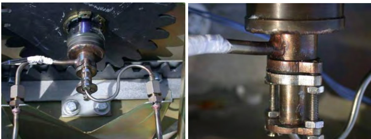
Abb. 128: Koaxialrohranschluss mit Ventileinstellung an einem Kollektor
