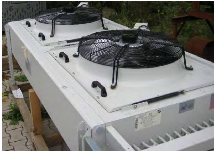
Abb. 89: Trockenkühler mit Befeuchtung der Zuluft.
