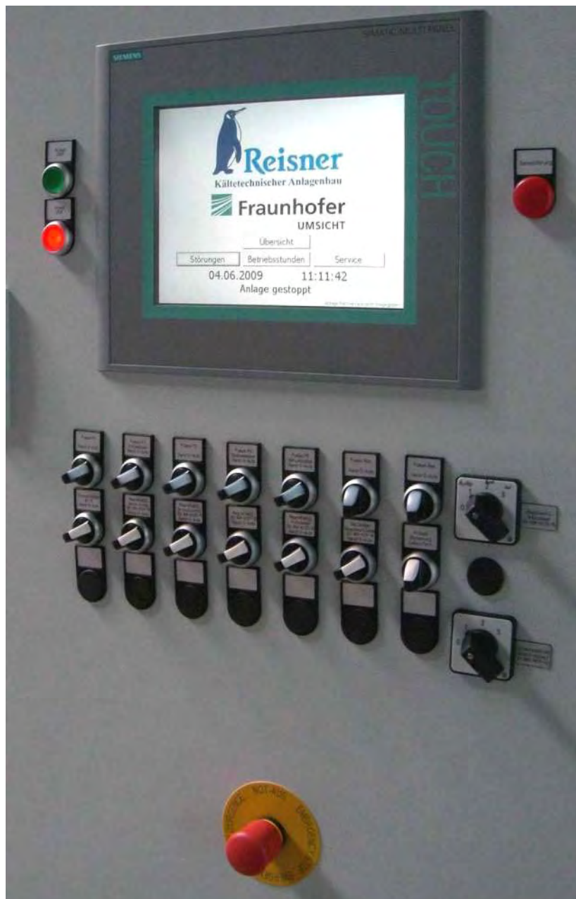
Abb. 109: Bedienfeld am Schaltschrank der DSKM [Bildquelle: Reisner AG].
