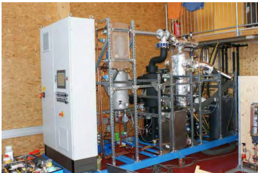
Abb. 119: Dampfstrahlkältemaschine im Labor der AEE INTEC in Gleisdorf
