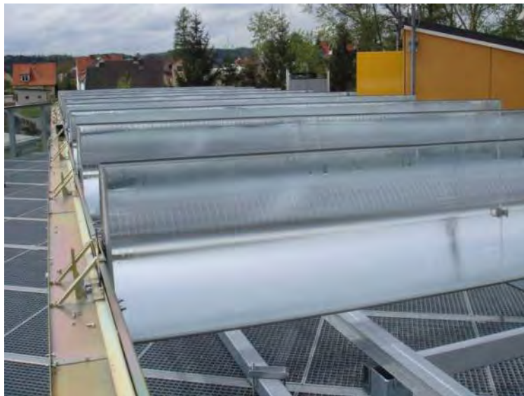
Abb. 55: Ansicht der Kollektoren auf dem Teststand vor dem Anheben des Gestells.
