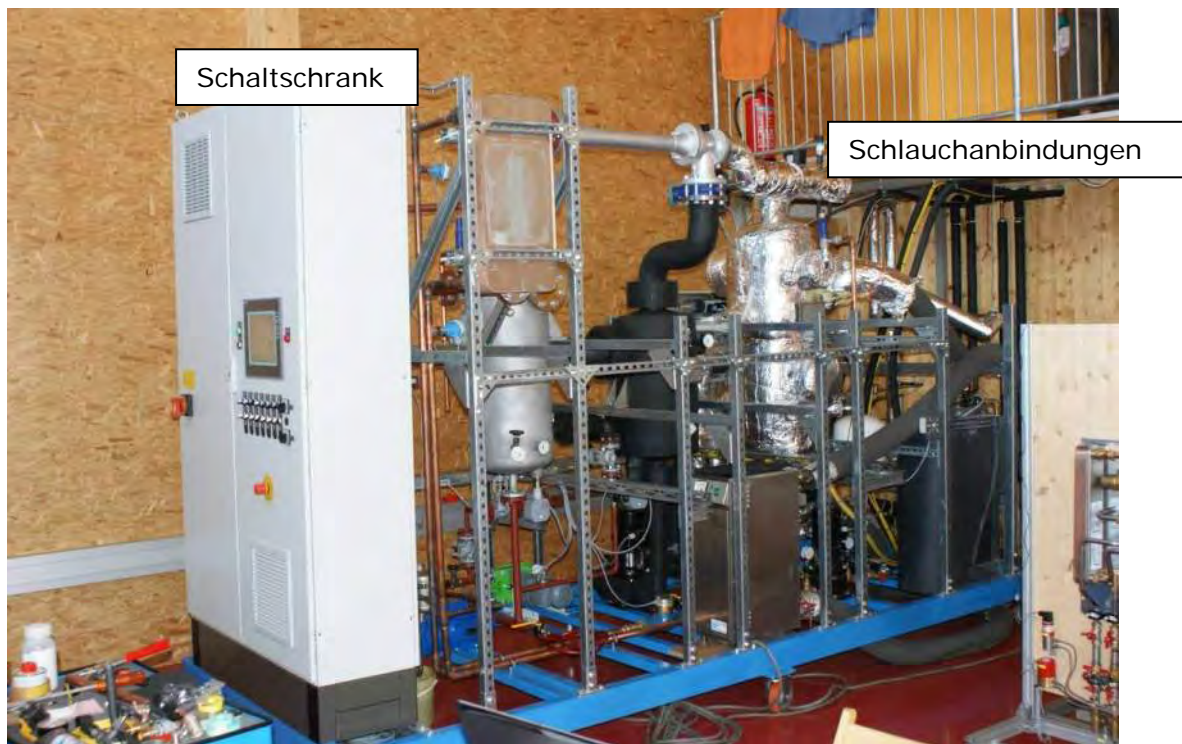
Abb. 129: DSKM im Technikum der AEE INTEC in Gleisdorf, Österreich.
