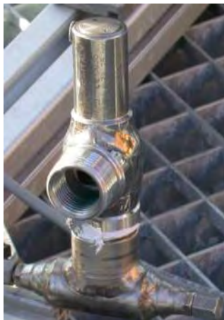
Abb. 60: Sicherheitsventil im Kollektorkreis
