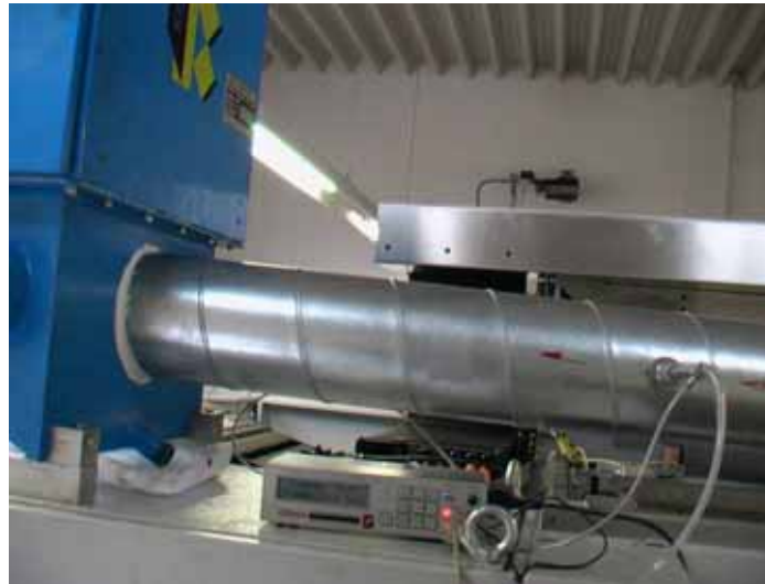
Abb. 8: Isokinetische Probenahme im rohgasseitigen Abluftkanal und optischer Partikelzähler
