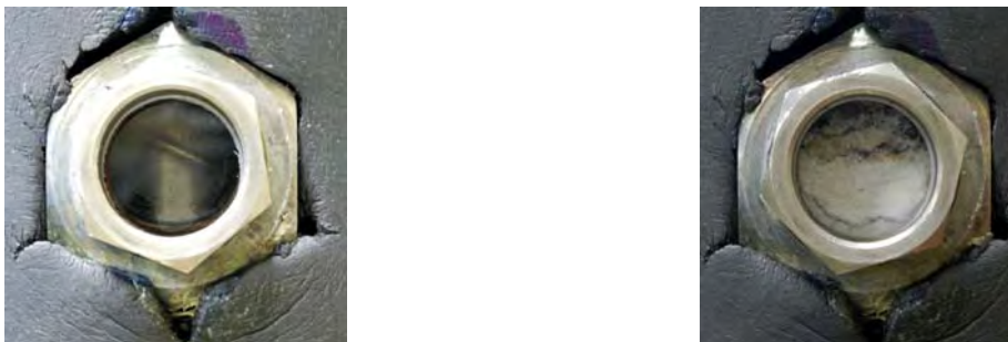
Abbildung 4-18: Schauglas im unteren Teil des Verdampfers: links – normaler Betrieb; rechts – Entstehung der NaOH-Kristalle
